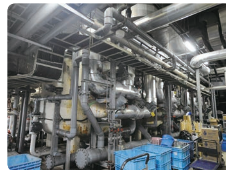
葛西臨海水族園のバックヤードにある大型の濾過槽
