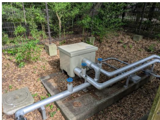
ポンプ設備更新時にインバーターを導入(上野)
